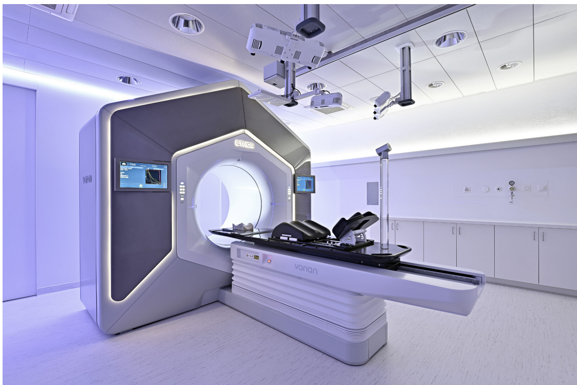
L'accélérateur linéaire Ethos™ installé au Centre de radio-oncologie de La Source
